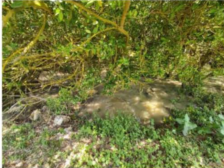
Foto 9. Tubería #2 en dique privado.
